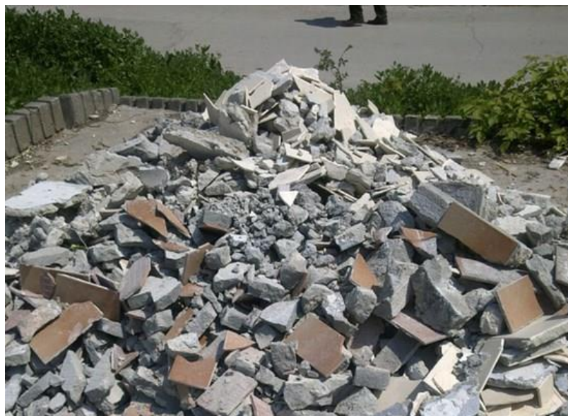
Изображение на СООт разрушаване
