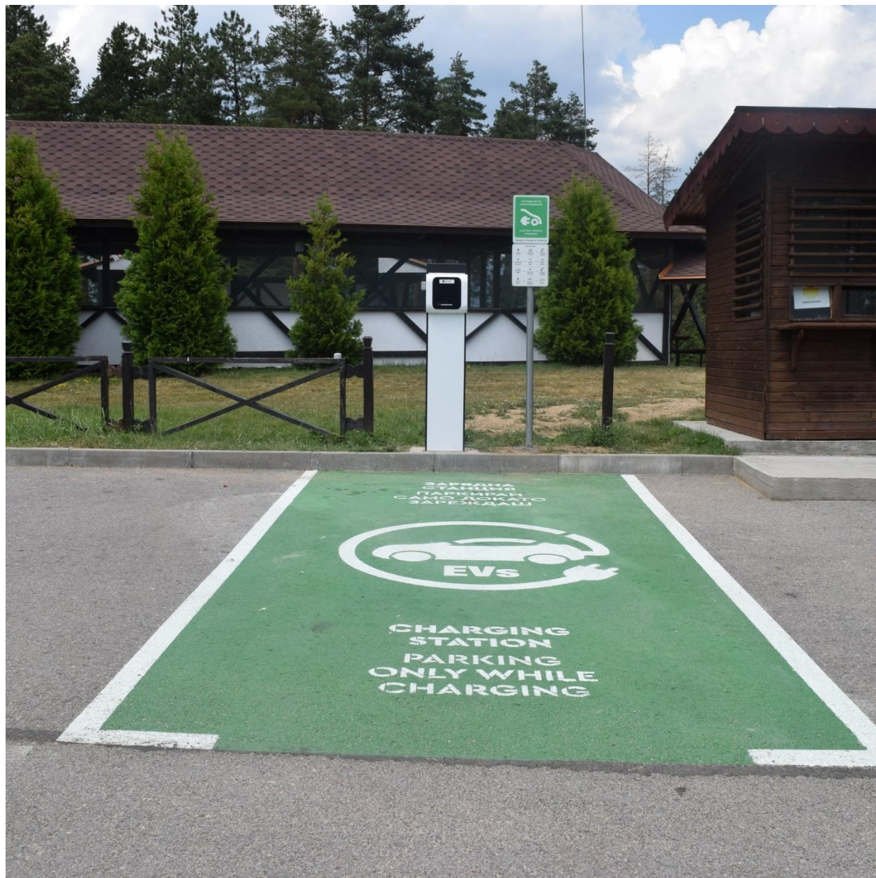
Зарядна станция с. Чавдар
